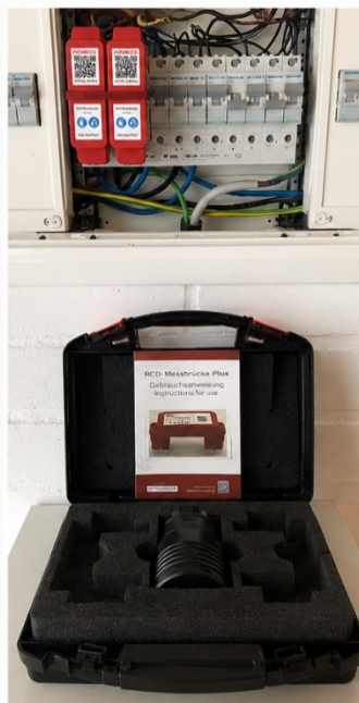
Bild 2: Schleifenimpedanzmessung in einer Gebäudeunterverteilung mit RCD-Messbrücke
