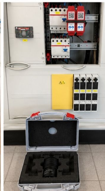
Bild 3: Schleifenimpedanzmessung an einer Hauptverteilung mit RCD-Messbrücke
