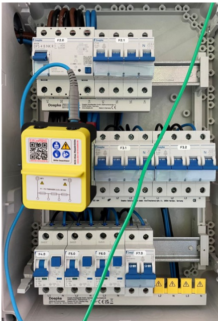
Bild 2: korrekte Positionierung der RCD-Riso Messbrücke
