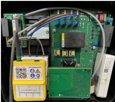
Bild 4: Riso-Messung an einer Wallbox mit integriertem RCD bei 500 V DC Messspannung
